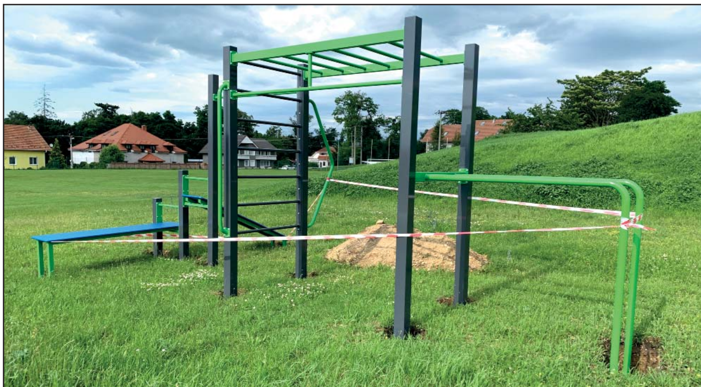
Zelenající se areál hřiště s herními prvky a lanovou dráhou ve výstavbě
